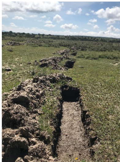
Figura 6. Tinas ciegas para captación de agua
